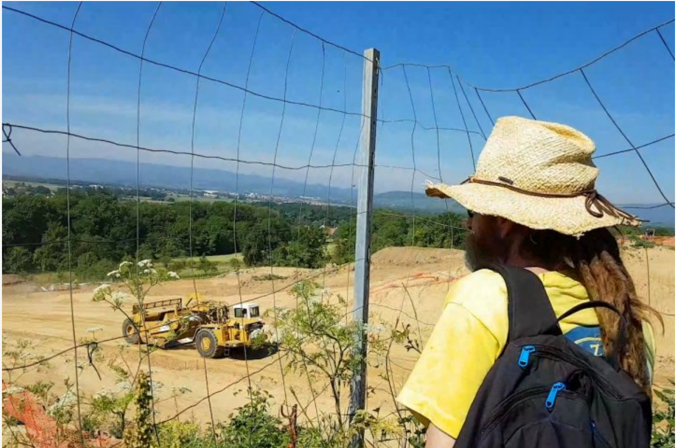
À Kolbsheim, en Alsace, travaux sur le tracé du grand contournement ouest (GCO) de Strasbourg (juin 2019).
